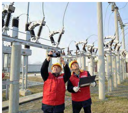
国网浙江省电力杭州供电公司 智能变电站的电量计量与监控项目
